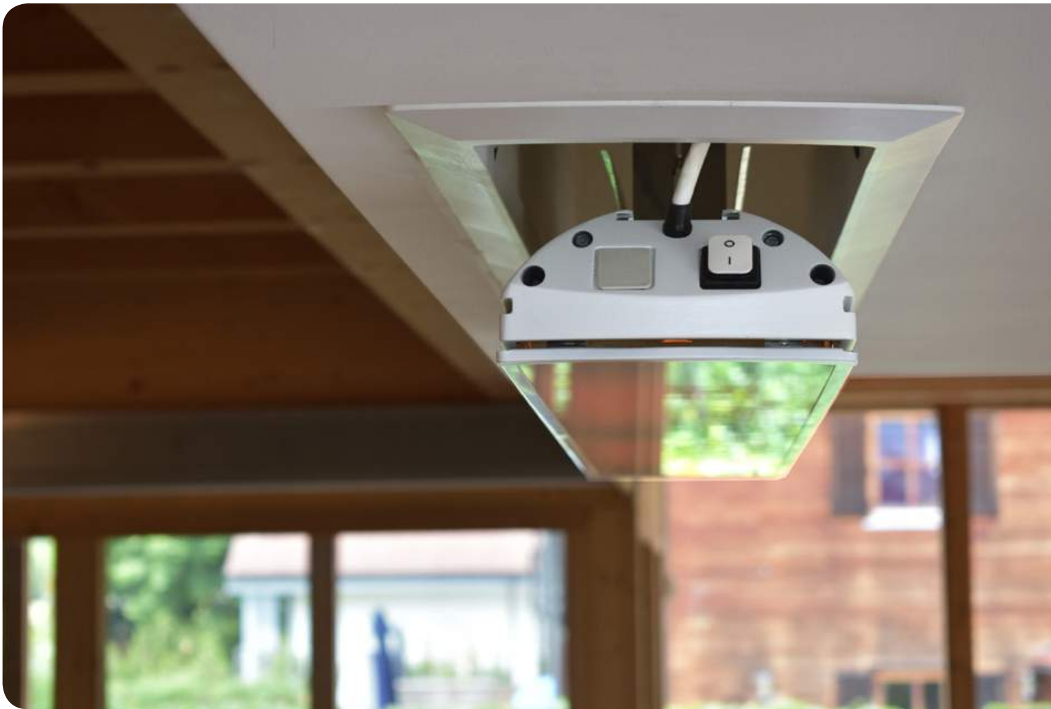
Flächenbündiger Deckeneinbau, Sauerlach · Deutschland
